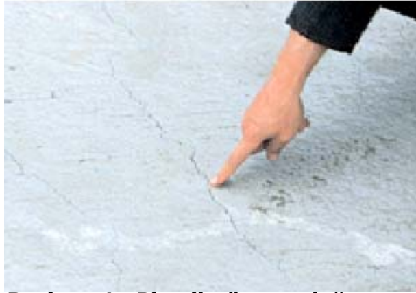
Resim – 1 : Plastik rötre çatlağı
